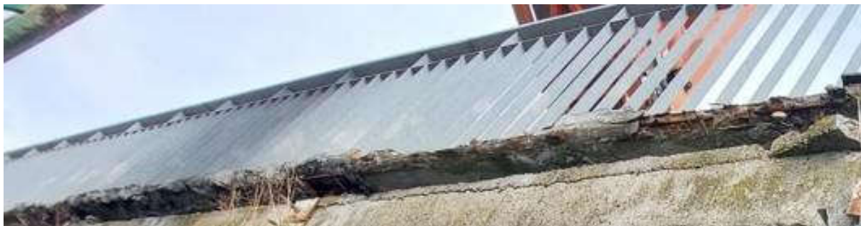
Тротуарные железобетонные блоки разморожены до арматуры
