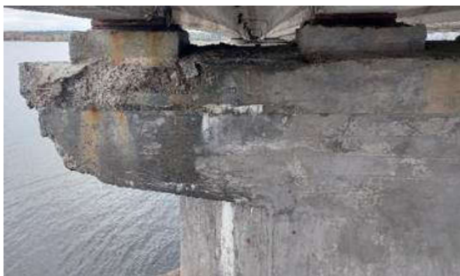
Размораживание бетона с оголением арматуры опоры №2
