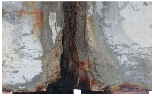
Разрушение (размораживание) торца балки
