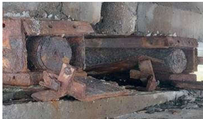
Отсутствие кожухов на подвижных опорных частях
