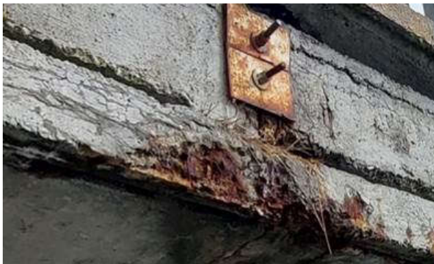
Сколы с оголением арматуры пролет №1
